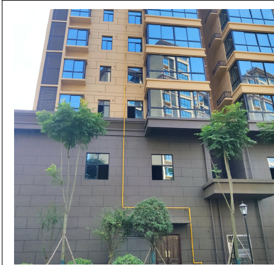
小区燃气管道
