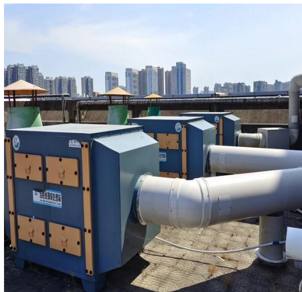
有机废气活性炭吸附装置及排放口
