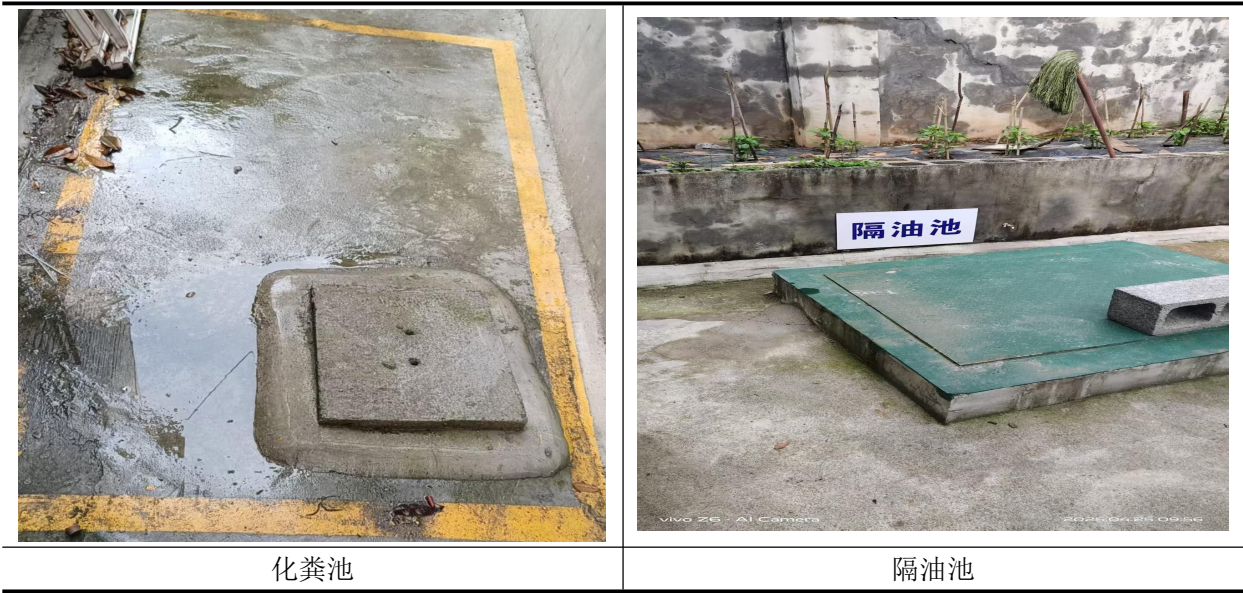
图 3-1 项目废水治理设施现场照片
