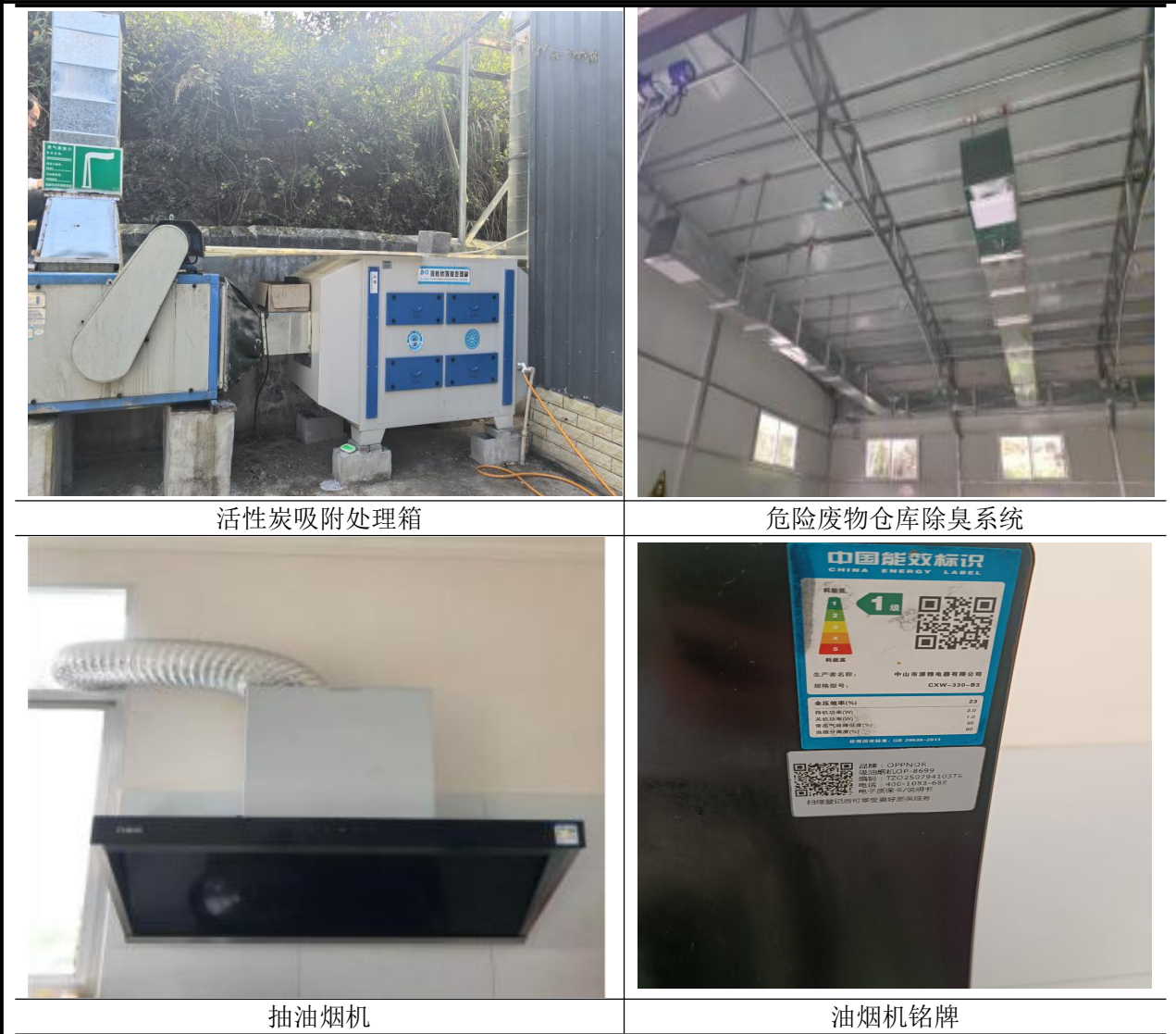
图 3-2 项目废气治理设施现场照片
