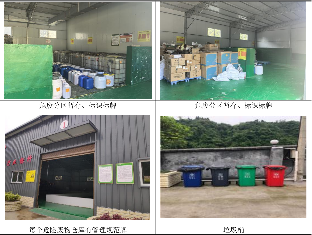
图 3-3 项目固废治理设施现场照片
